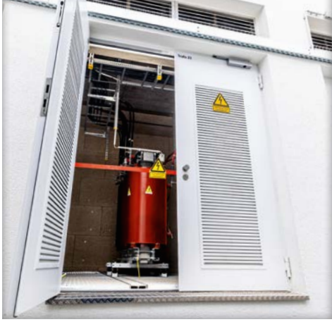
Transformatoren wandeln die 10.000 Volt in Niederspannung 230/400 Volt um, die dann zu den Steckdosen und Anlagen in den Gebäuden führt.
