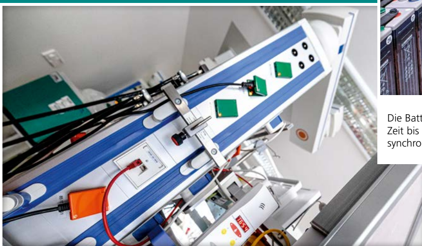
Lebenswichtige Geräte wie etwa Beatmungsgeräte müssen auch bei einem Stromausfall kontinuierlich weiter laufen. Grüne Steckdosen werden deshalb bei einem Stromausfall über ein Notstromaggregat versorgt. Rote werden über Akkus gepuffert, so dass sie im Notfall ohne Unterbrechung weiter mit Strom versorgt sind.
